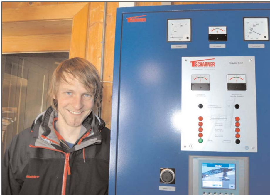
Der Erneuerer: Claudio Tscharner sieht es als Herausforderung, in die Tage gekommenen kleinen Liftanlagen durch ABB FU für den Betreiber kostengünstig zu einer modernen Technik zu verhelfen. Hier präsentiert er das Herz der neuen Anlage am Skilift Stöfeli.
